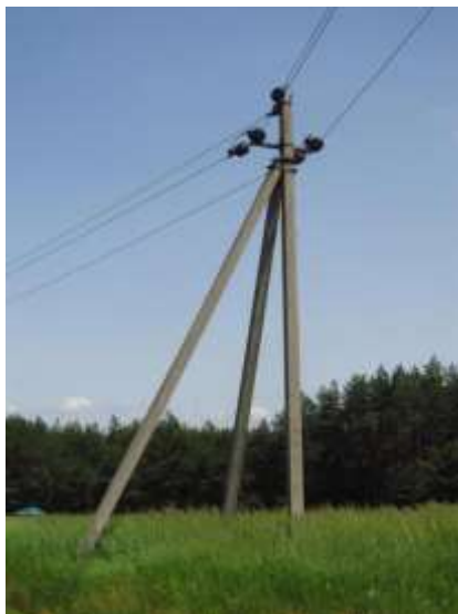
Рисунок 2. Железобетонная опора ВЛ-10 кВ
