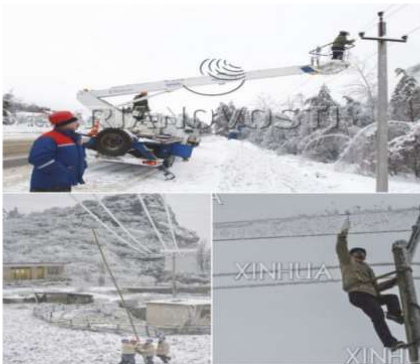
Рисунок 4. Механическое удаление отложения льда с проводов
