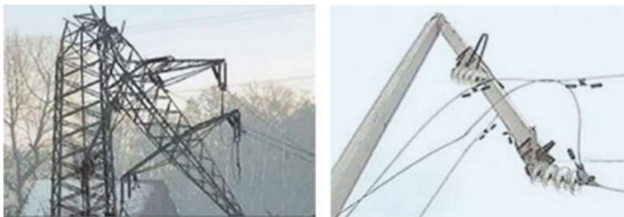
Рисунок 2. Гололёд – бедствие для линий электропередач
