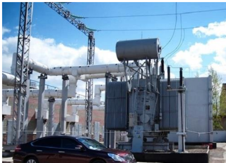
Рисунок 4. Подстанция глубокого ввода
