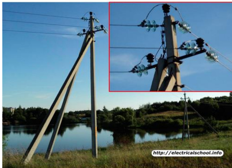
Рисунок 7. Натяжные гирлянды изоляторов на ВЛ- 10 кВ
