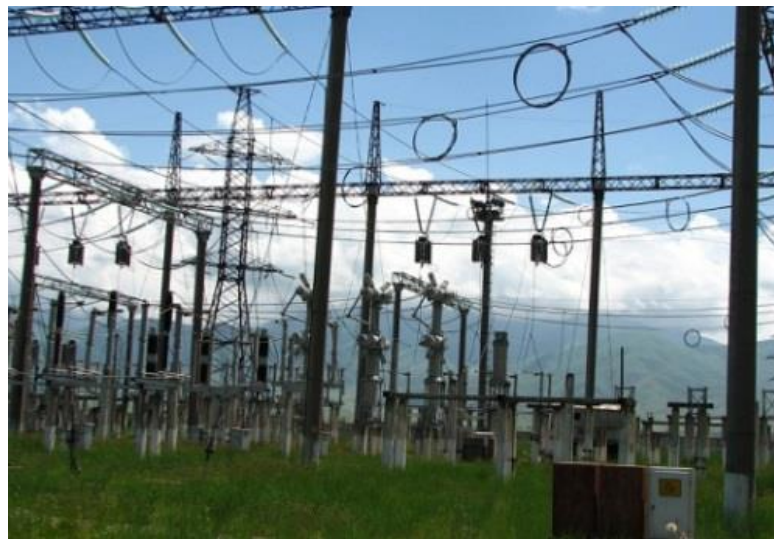
Рисунок 2. Узловая распределительная подстанция.
