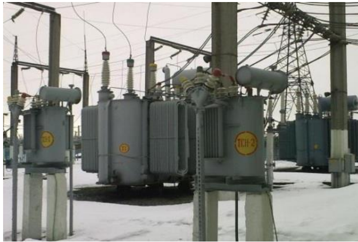
Рисунок 3. Главная понизительная подстанция
