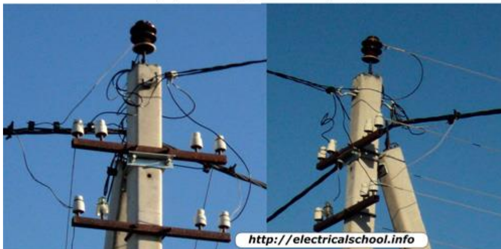
Рисунок 5. Штыревые фарфоровые изоляторы на опорах ВЛ-0,4 кВ с открытыми и самонесущими изолированными проводами
