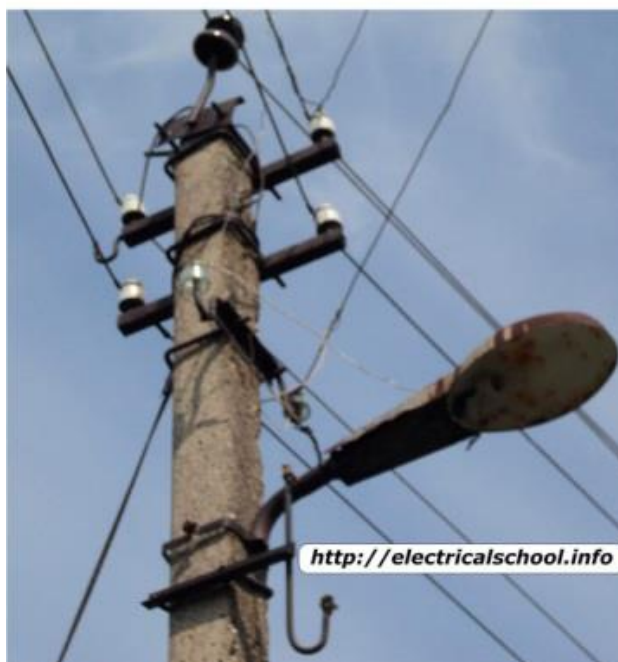
Рисунок 3. Опорные изоляторы на воздушной линии 0.4/0.2 кВ
