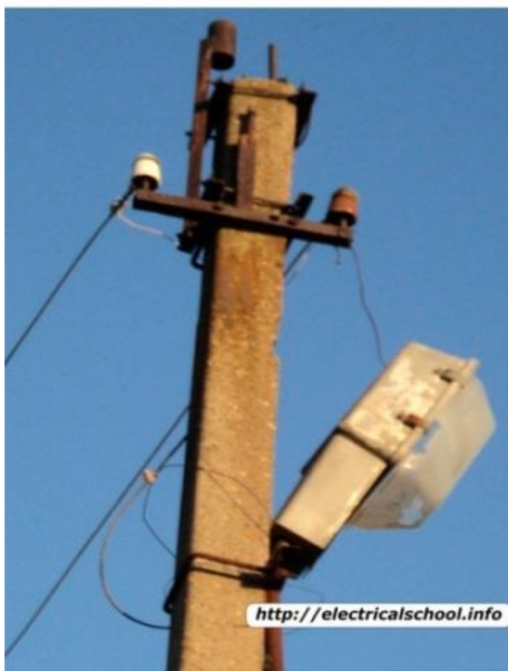
Рисунок 2. Штыревые изоляторы на ВЛ-0.2 кВ для подключения светильника уличного освещения
