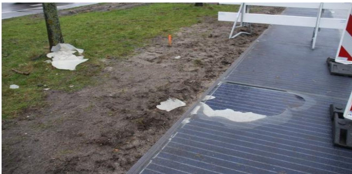
Рисунок 2. Дефекты участков покрытия SolaRoad
