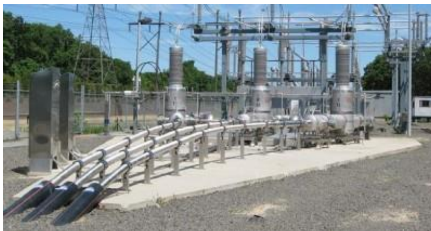
Рисунок 4. ВТСП-кабель 138 кВ (2400 А) длиной 660 м.
