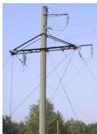
Рисунок 4. - Железобетонная опора 110кВ.
